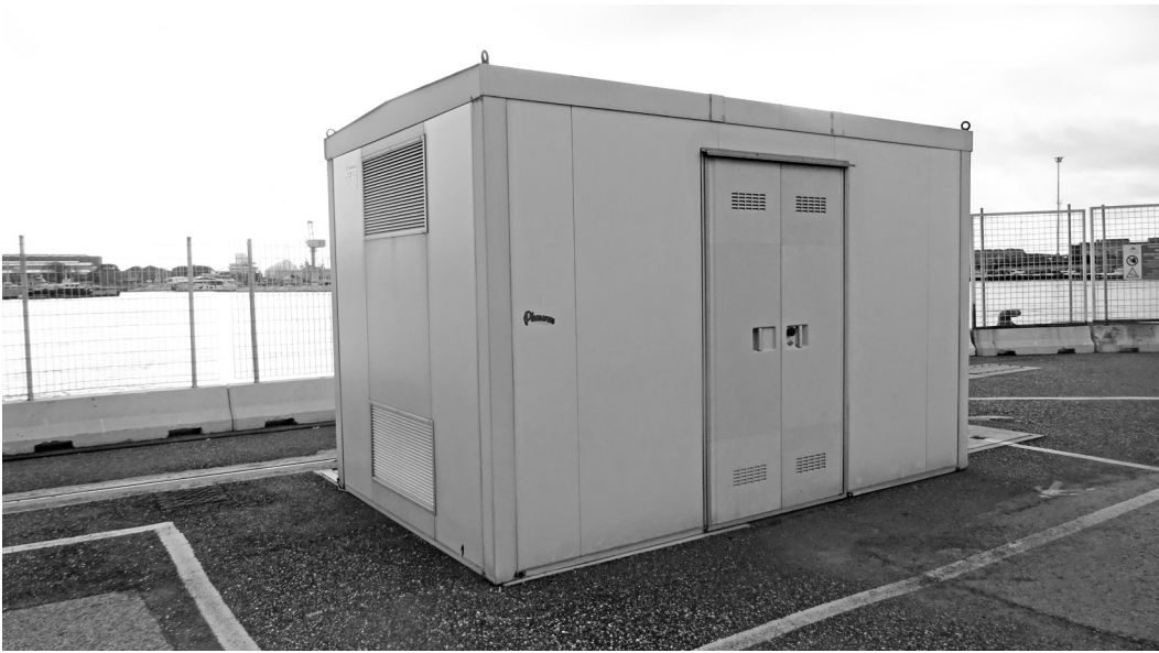
Nella foto: Un impianto di banchina a Livorno del cold ironing.
