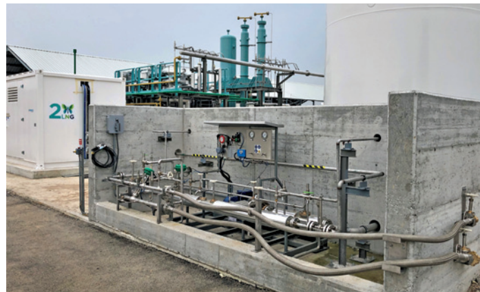
Nella foto: Una installazione della pompa Vanzetti.
